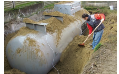
Protezione catodica già collegata Cathodic protection already connected
